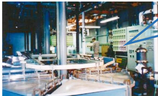
電解硬質金めっき自動2号機
